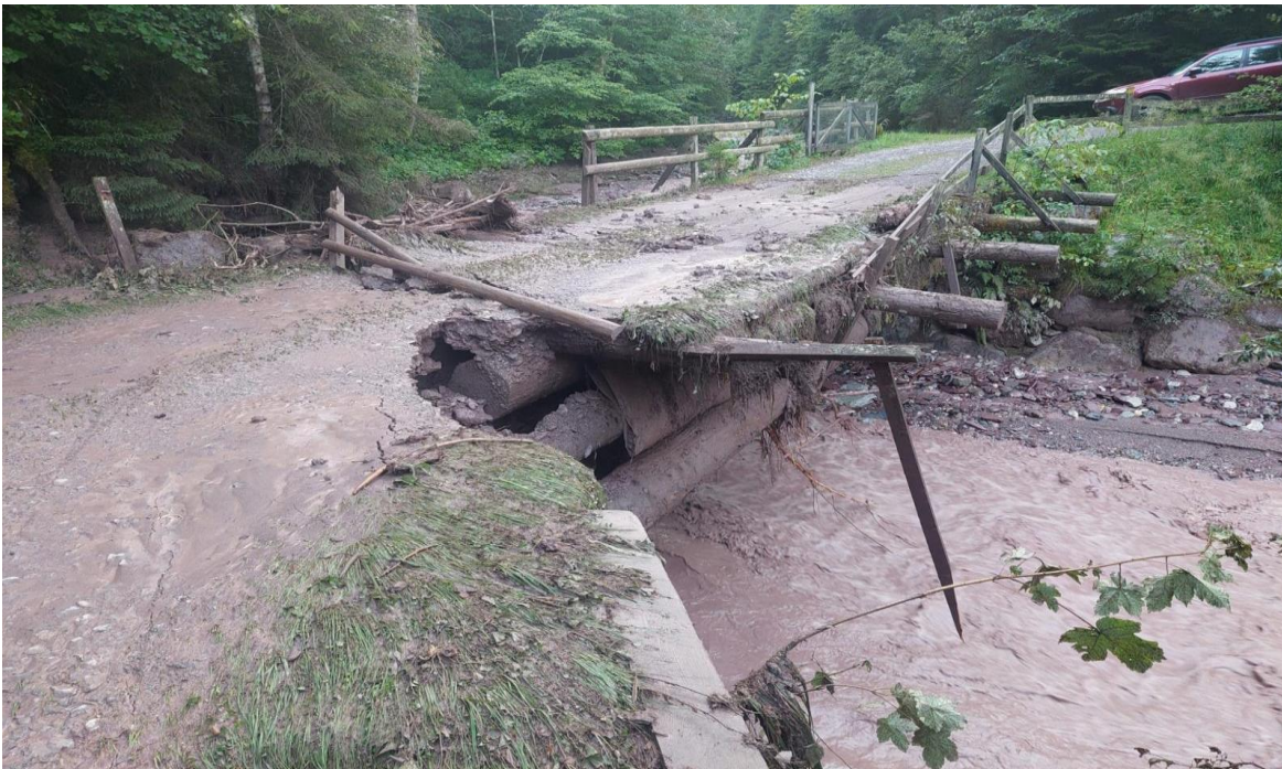
Bildbrücke nach Unwetter 12.08.2024
